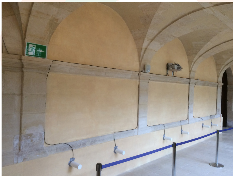
Humidité dans les murs (Val de Grâce Paris)
